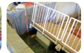
フローティング止水デッキ
